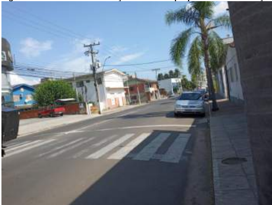
Figura 49 – Trecho com sinalização horizontal que precisa de manutenção.
