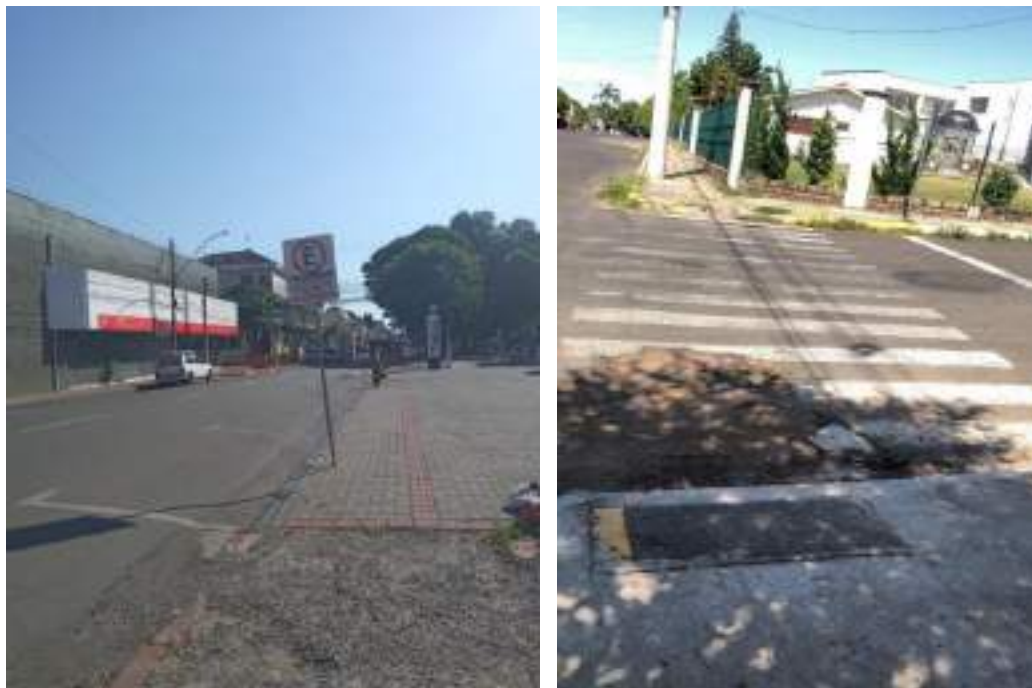
Figura 76 – Problemas com o piso tátil e rampa
