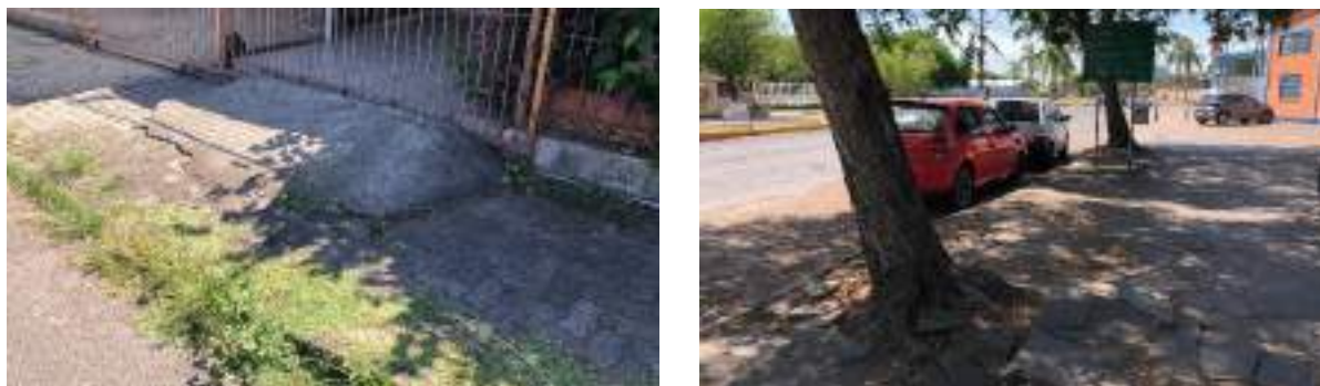
Figura 77 – Problemas encontrados em calçadas
